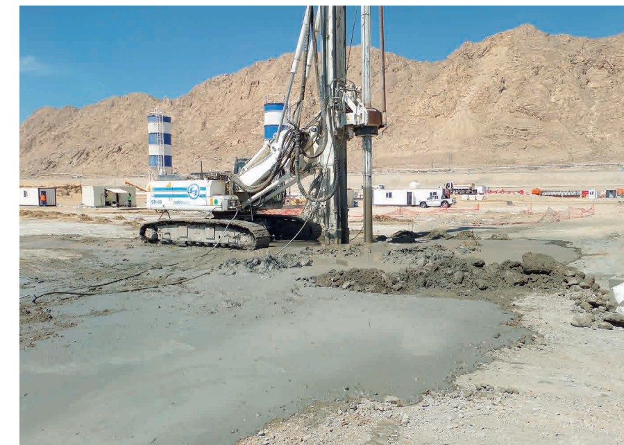
Deňiz portunda yzgarlanan teýgumlarda «jet» tehnologiýasy boýunça topragy «sement ergini bilen garmak» usuly Cementation by the method of «ground mixing» using «jet technology» on water-saturated ground during the construction of seaport Цементация методом «грунтосмешения» по технологии «jet» на водонасыщенных грунтах при строительстве морского порта
