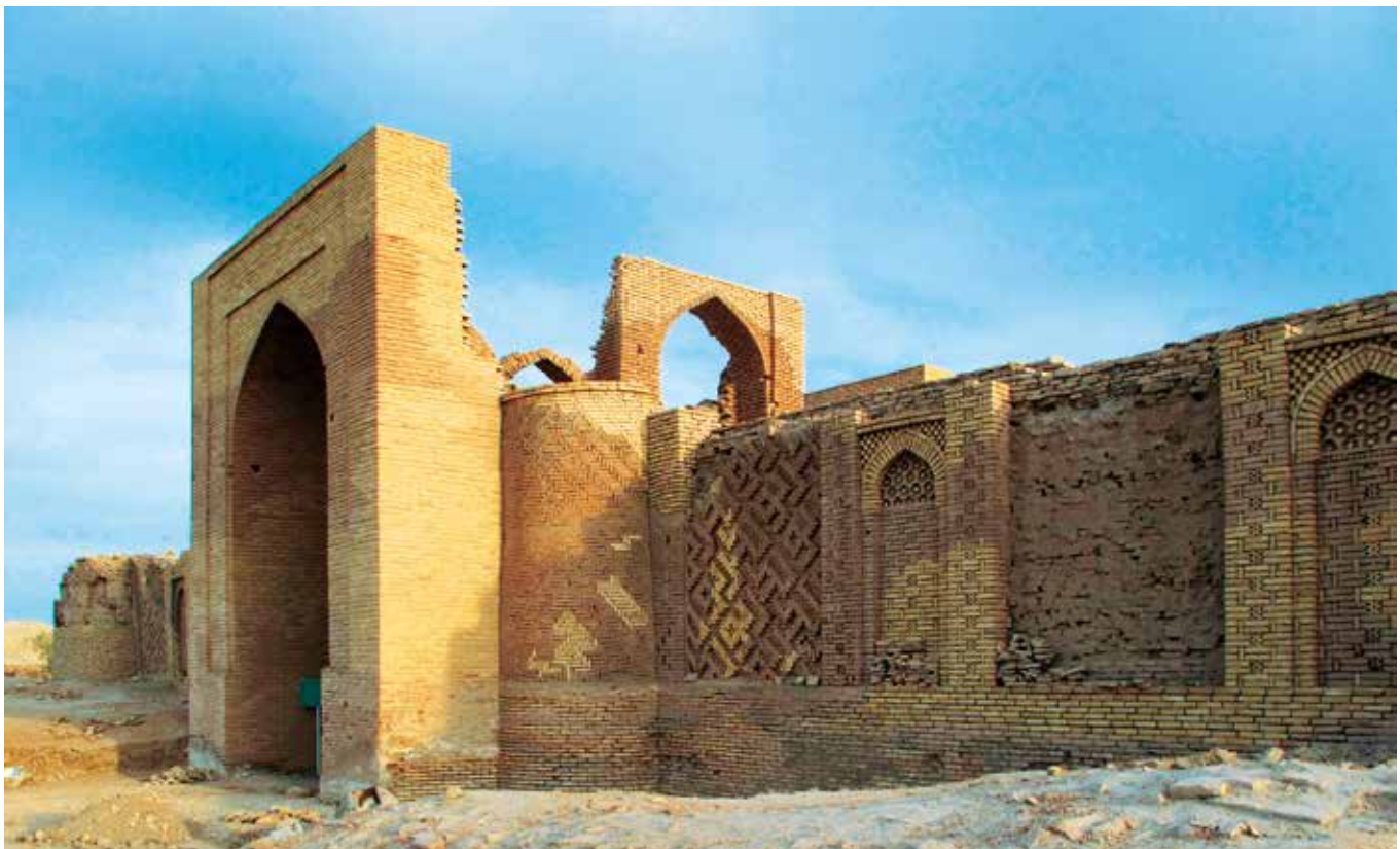
Lebab welaýatyndaky Daýahatyn kerwensarawyň amaly-dikeldiş işindäki diwar ýüzi. Facade of the Dayahatyn caravanserai in the Lebab region in the process of practical restoration. Фасад нараван-сарая Даяхатын в Лебапском велаёте в процессе практической реставрации.
